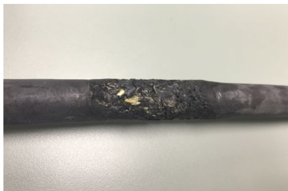
Cable óptico degradado por el efecto tracking.
